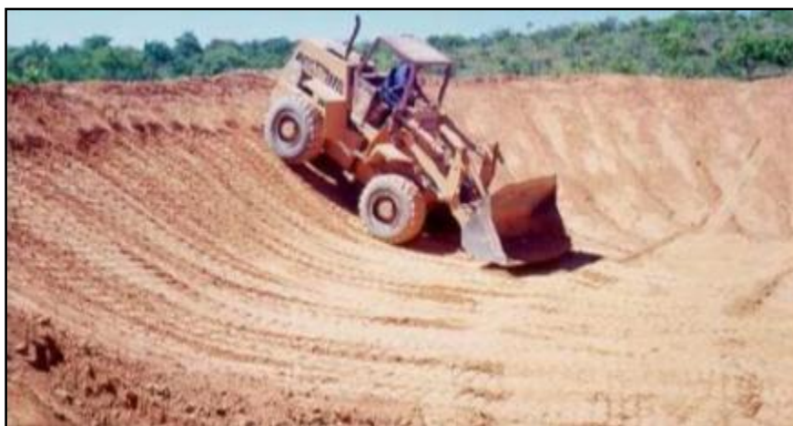
Figura 107 - Construção de bacia de contenção de enxurrada em Sete Lagoas – MG. (EMBRAPA, 1997).
