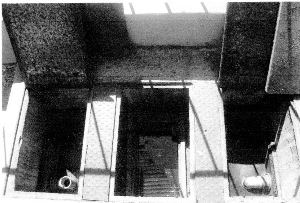
Foto 01: Em destaque a caixa separadora de água/óleo do empreendimento.
