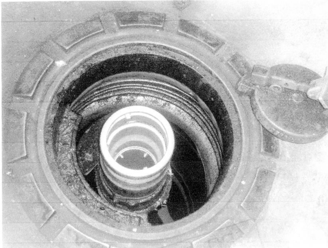
Foto 05: Ponto de descarga com SUMP .
