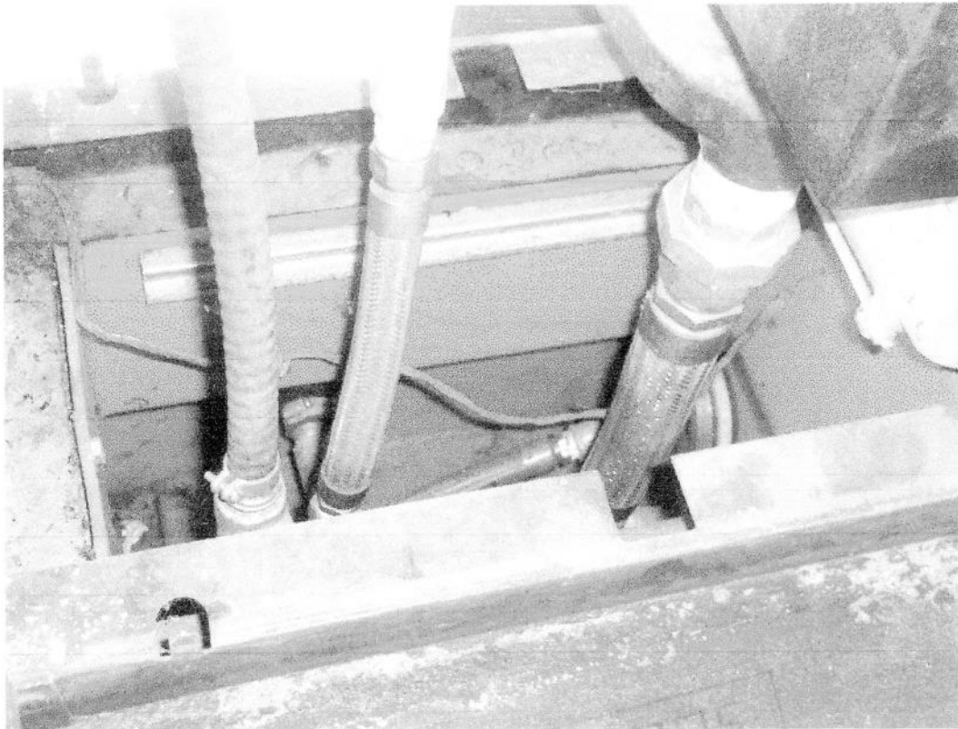
Foto 07: SUMP do filtro de óleo.
