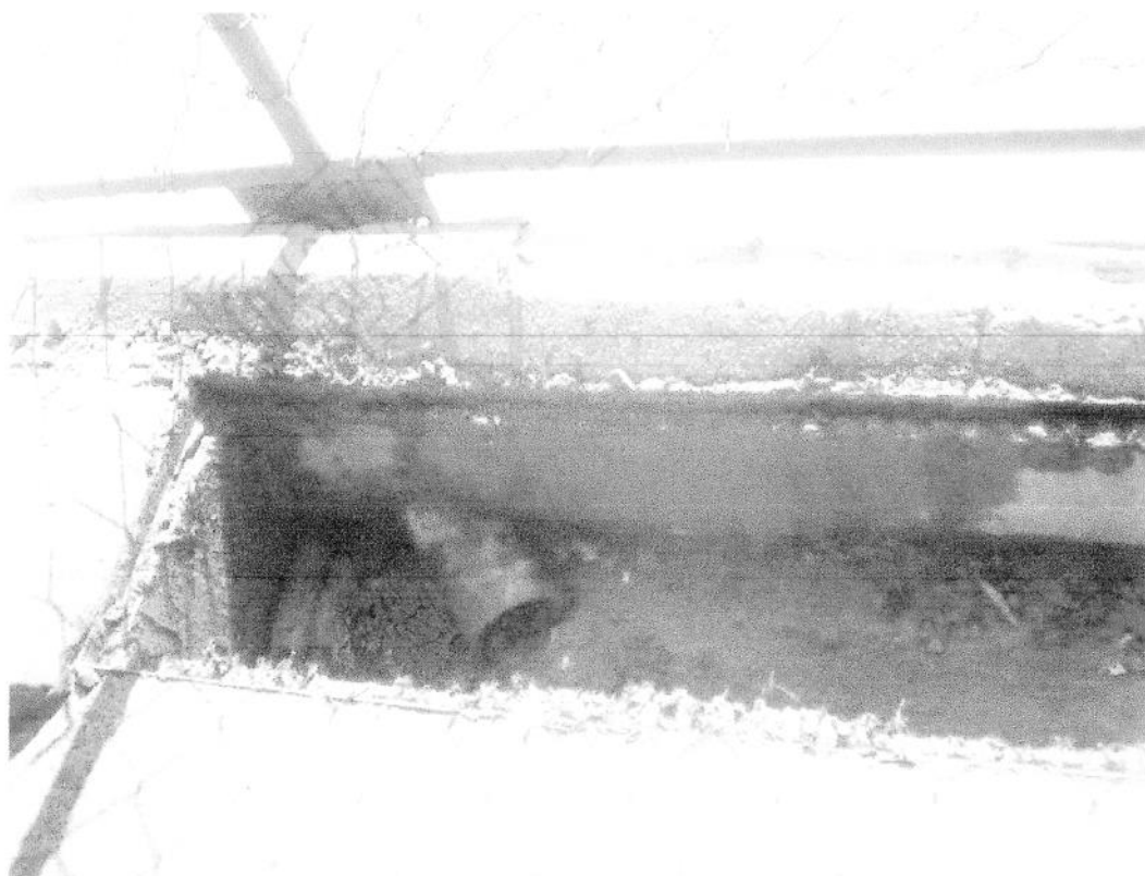
Foto 10: Galeria interligada diretamente a rede de esgoto com presença partes sólidas.
