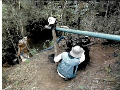
Foto 19: Ponto de captação de água com motor-bomba.
