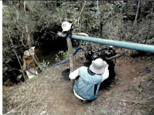
Foto 19: Ponto de captação de água com motor-bomba.
