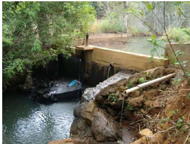
Figura 48 - Ponto de captação para abastecimento doméstico e industrial da sede municipal de Dolores de campos.
