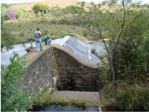
Figura 100 - Ponto de captação para abastecimento doméstico e industrial da sede municipal de São João Del Rei (Barragem do 14).
