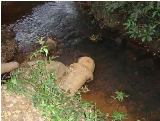
Figura 89 - Ponto de captação para abastecimento doméstico e industrial da sede municipal de Ibertioga.
