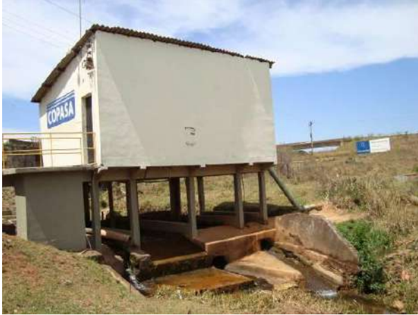
Figura 28 - Ponto de captação para o abastecimento doméstico e industrial da sede municipal de Barbacena.
