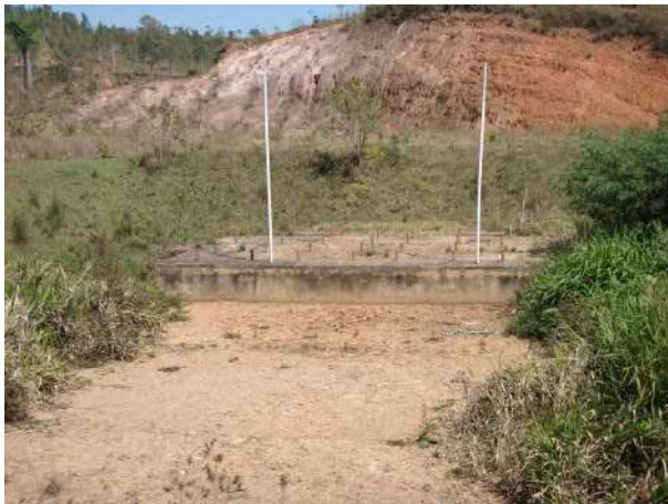
Figura 22 - Estação de tratamento de esgoto da sede municipal de Barbacena trata aproximadamente 5% dos efluentes.
