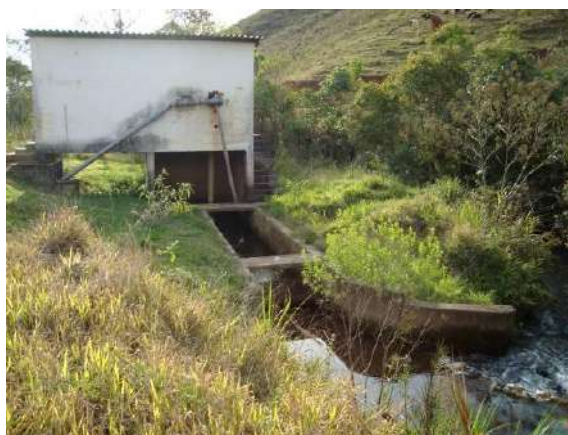
Figura 16 - Ponto de captação para abastecimento doméstico do distrito de Correia de Almeida (Barbacena).
