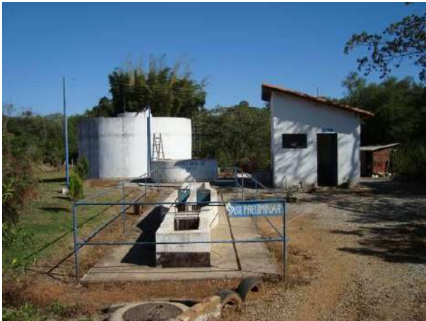
Figura 82 - Estação de tratamento de efluentes da sede municipal de Ibertioga.
