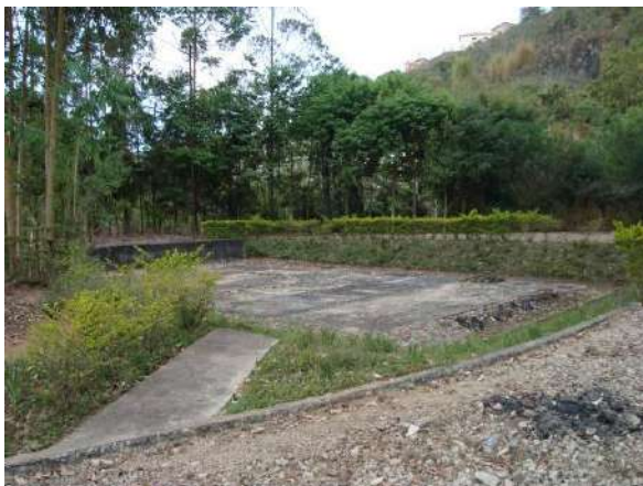
Figura 14 - Estação de tratamento de esgoto do distrito de Senhora das Dores (Barbacena).
