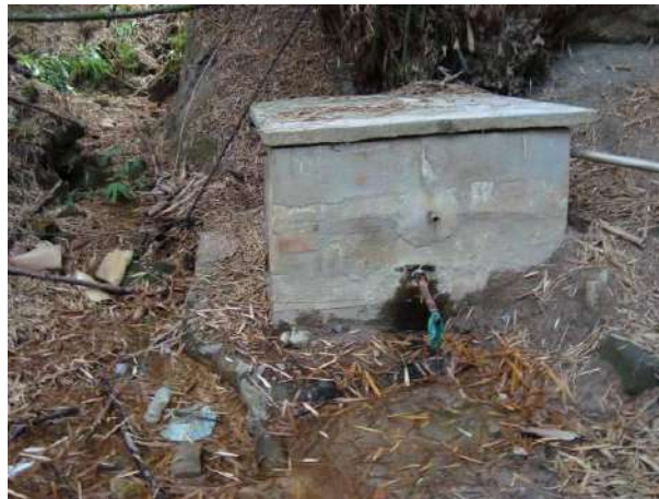
Figura 114 - Captação para o abastecimento doméstico do povoado rural Prainha (Ritápolis).
