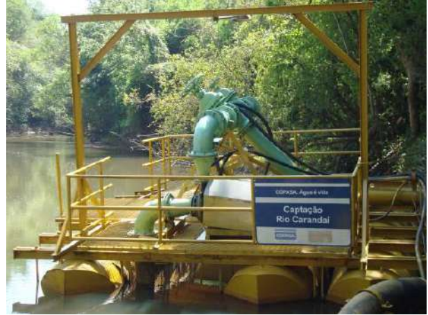
Figura 64 - Em destaque balsa de captação para o abastecimento doméstico e industrial de São João Del Rei e das localidades rurais de Cesar de Pina e Águas Santas ambas pertencentes a Tiradentes.
