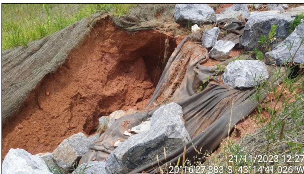
Foto 21: Erosão causada pela chuva.
