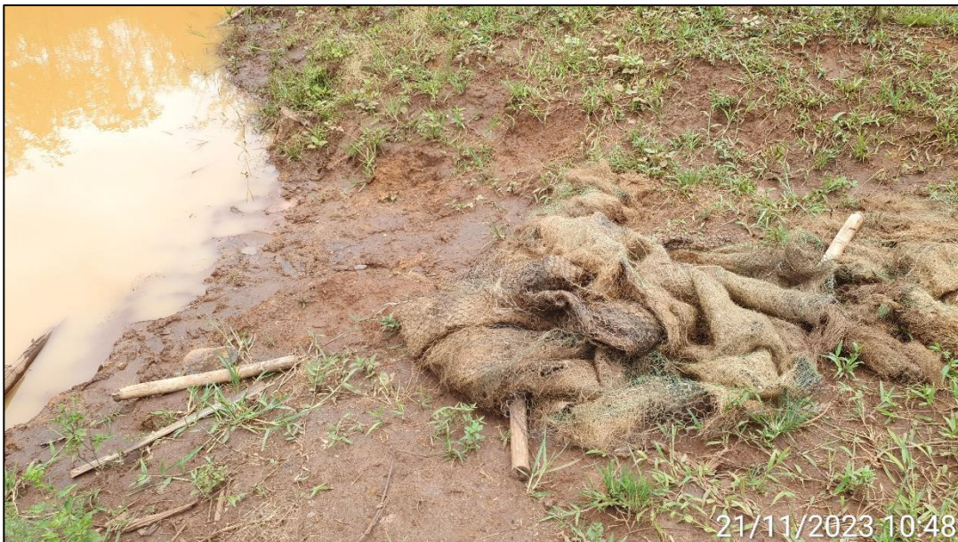
Foto 11: Detalhe da presença de biorretentores danificados.
